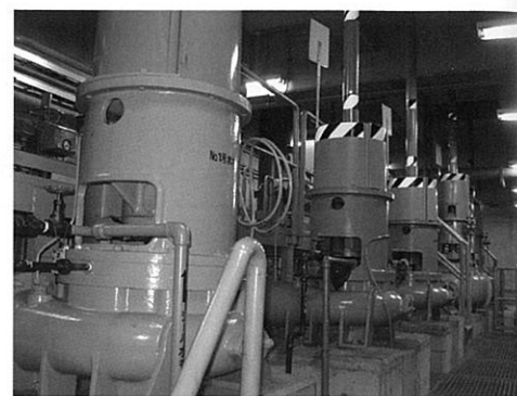
ポンプ棟内ポンプ
