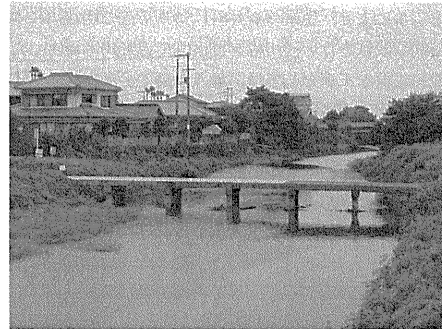
【写 3-3】 洪水時に水中に没する岡橋（大正3年）
