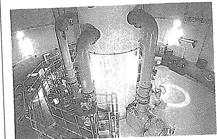
揚水ポンプ室
