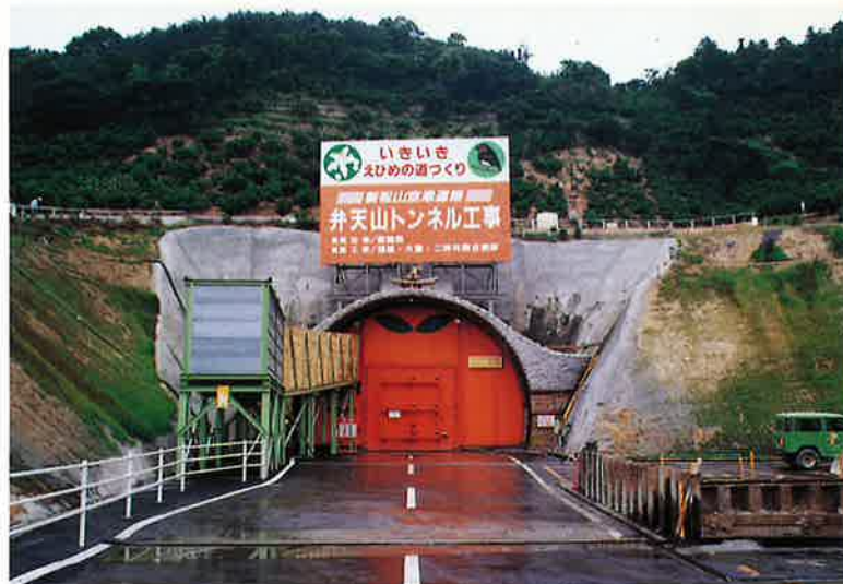
写2. 防音扉 (W=1.0m 砂充填式) ファン・ダクト防音設備
