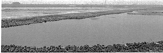
写真18 第十堰（地上写真） 第十堰は毎年のように洪水被害を受け、 補修を重ねて維持してきている。
