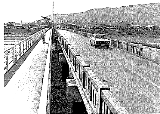
老朽が進んだ安芸川橋(安芸市、昭和48年) *
