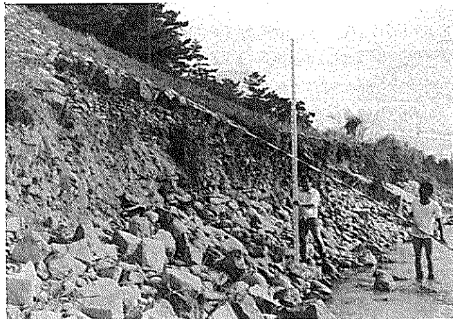
昭和50年の台風6号による出水は戦後最大の洪水となり、随所で甚大な河道災害をもたらした（11K/5左岸堤防の堤脚洗掘状況）
