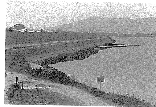
藍住洗掘対策
