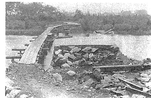
岡川清水橋流失（コンクリート潜水橋）
