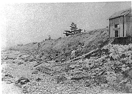
赤池第2護岸工事現場の被害状況
