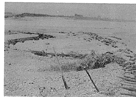
富岡水門の被害状況
