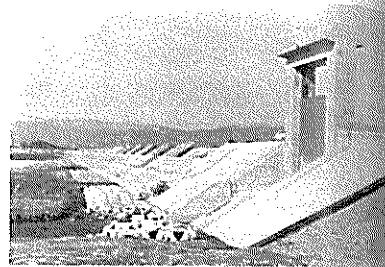
工事中の左岸高潮堤防、手前に見えるのが完成した吉川水門
