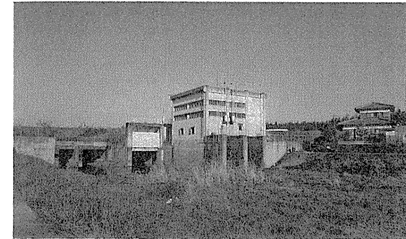
写真 2.4.23 岩屋谷川排水機場
