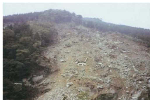
地滑りで崩落した工事用道路
